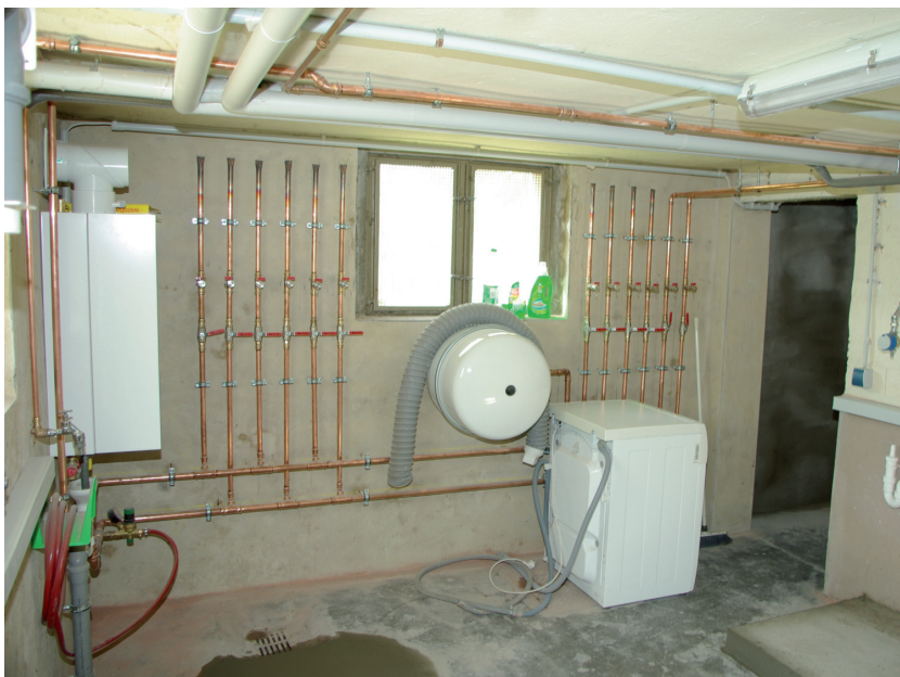
Gaszentralheizung Bruckner Str. 74
